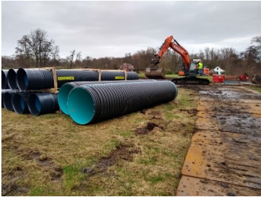
Figuur 5. De buizen liggen klaar voor de verbinding van de verschillende sloten van de ijzerzandpassage.
