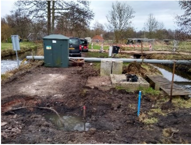
Figuur 4. Het oude gemaal en daarachter de noodbemaling in werking.
